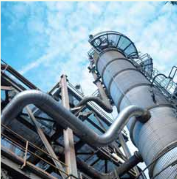
Central GICC de Polk Power en Tampa (Florida).
