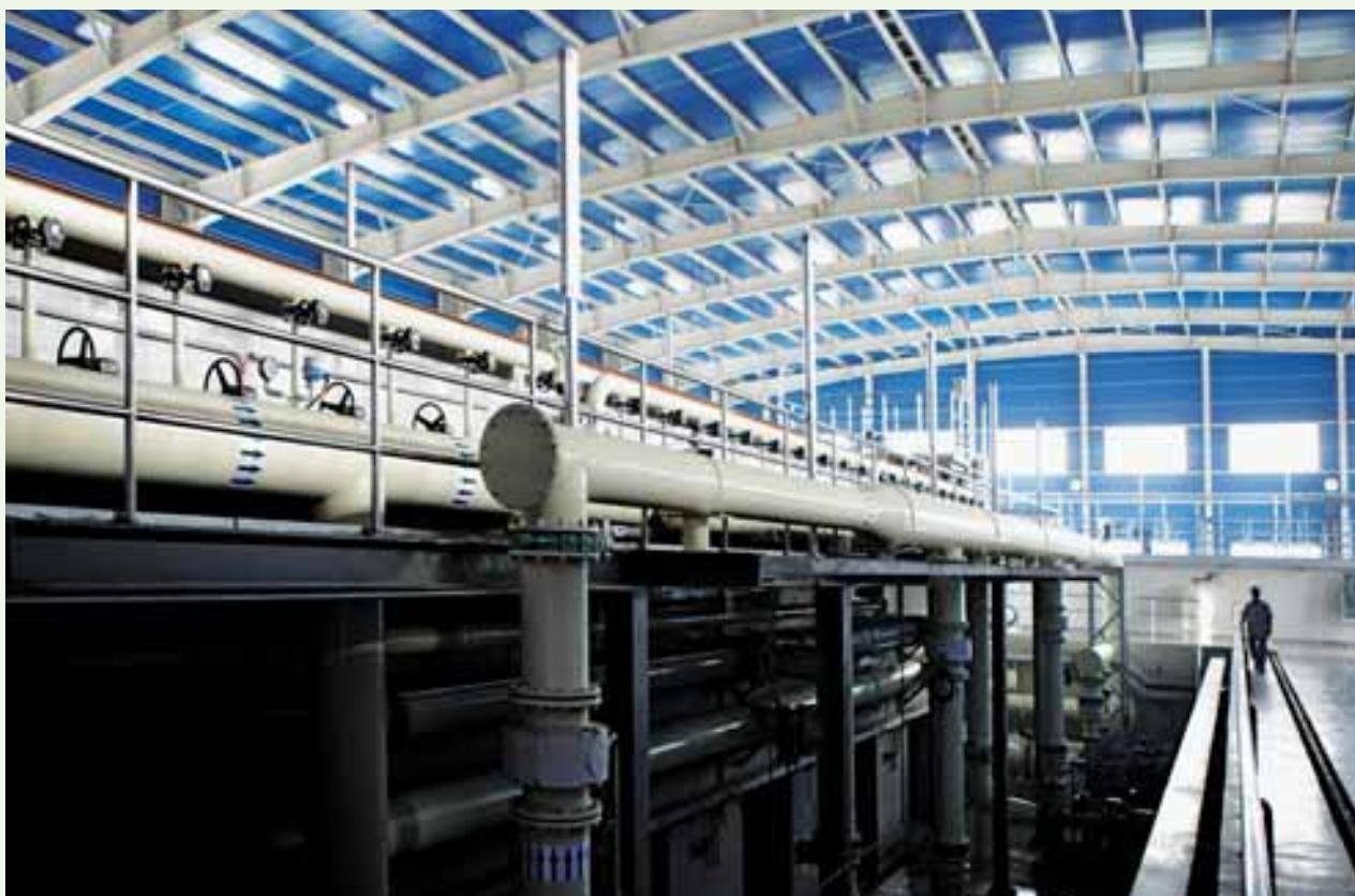
Instalaciones de depuración de agua de GE en Pekín (China).
